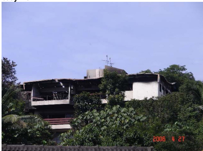
Foto. 3: Ogień uszkodził szczyt piętra domu, który został uderzony przez piorun.
