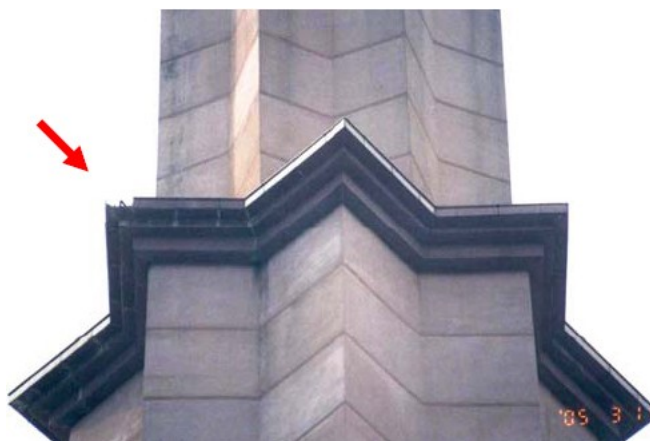
Figa. 7: Zbliżenie gzymsu minaretu uszkodzonego przez wyładowanie.
