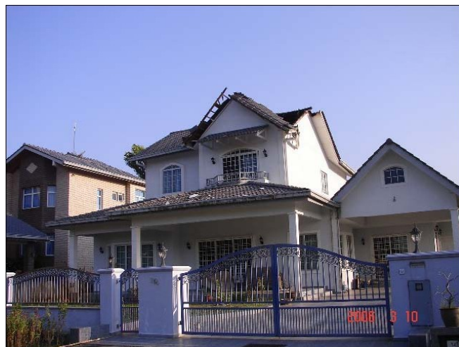
Foto. 1: Uszkodzenia dachu domu uderzonego przez piorun.
