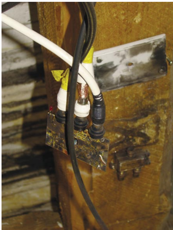
Instalacja RTV po wyładowaniu w antenę na domu jednorodzinny
